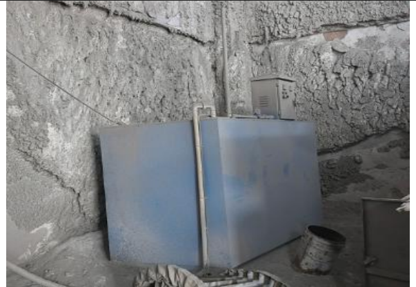
一体化生活污水处理设施
