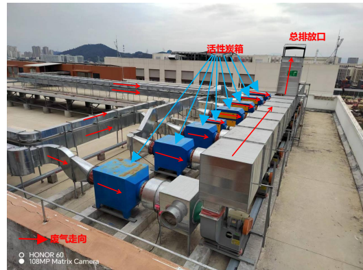
活性炭吸附装置及总排放口
