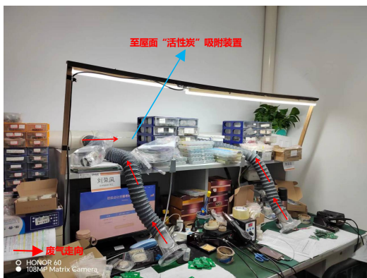
补焊工序集气罩及风管系统
