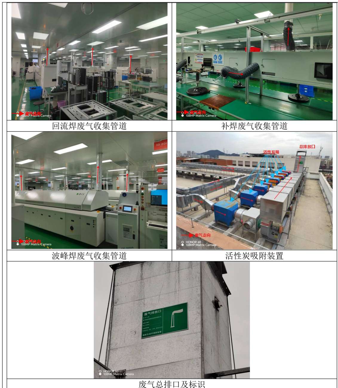
图 3-2 项目废气收集及处理设施图
