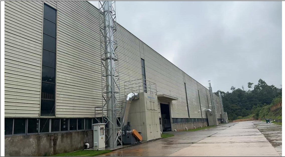
除尘设施和 DA001、DA002、DA003 排气筒
