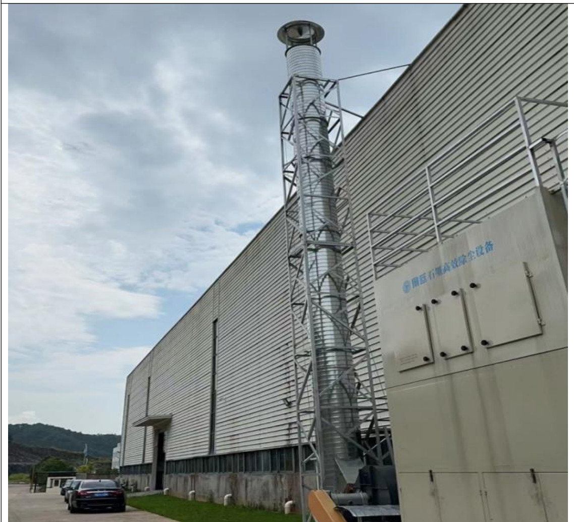
除尘设施和 DA004 排气筒
