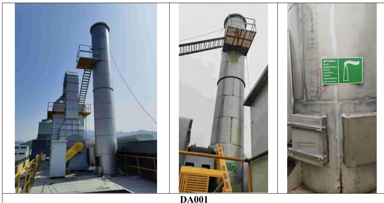
图 4.7-2 规范化大气污染物排放口现场照片
