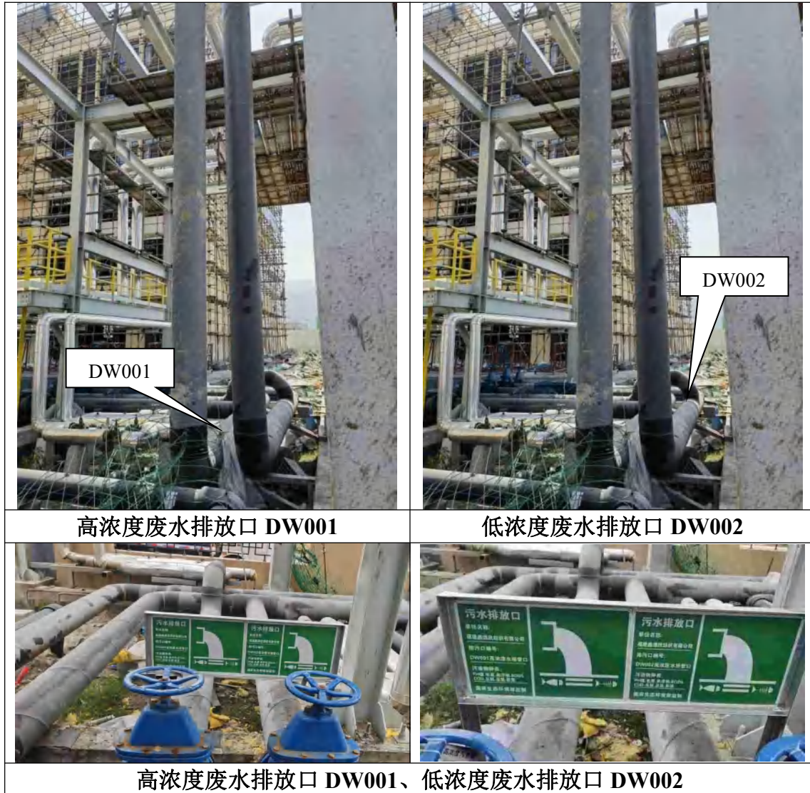
图 4.7-1 规范化污水排放口现场照片
