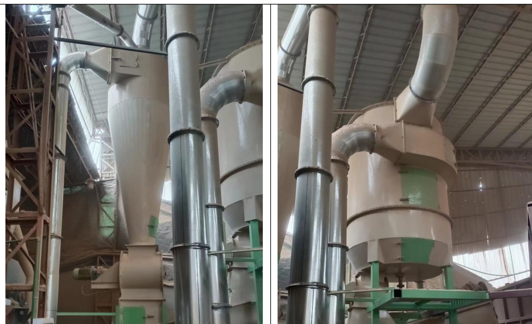
图 3-1 废气治理设施
