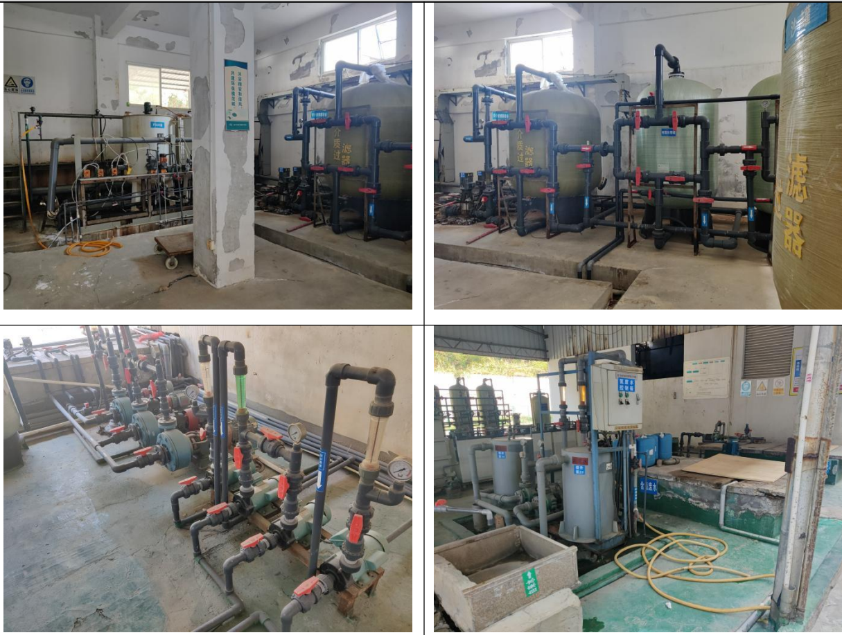
图3.1.3 废水处理设施图
