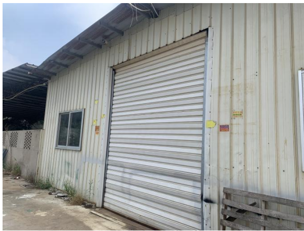
一般工业固废仓库
