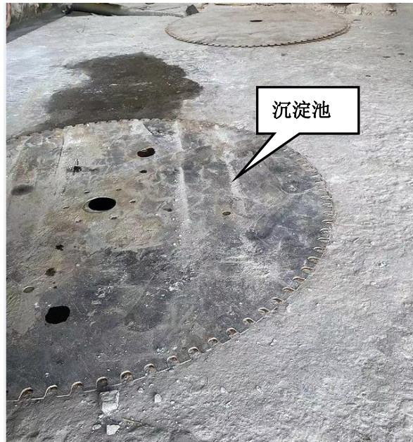
图 4-3 生产废水沉淀池
