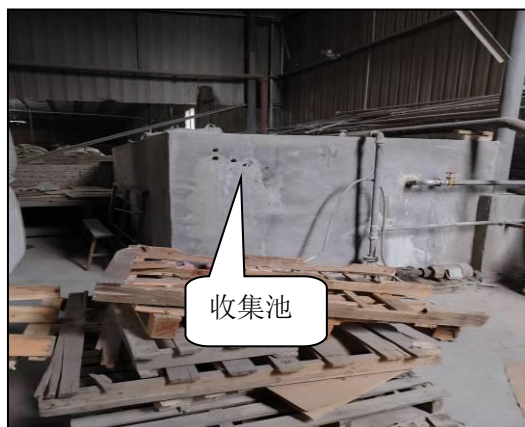
图 4-1-3 锅炉软化水系统浓水收集池
