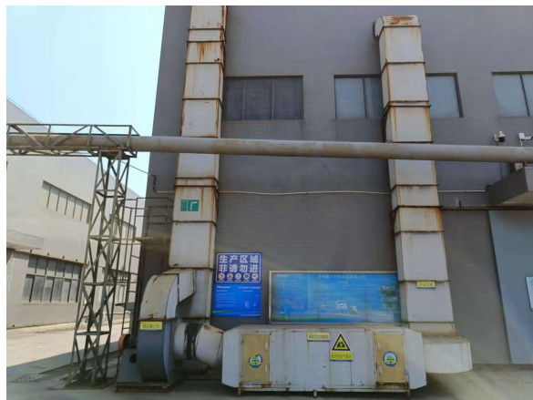
一期危废车间（含陈化库）尾气活性炭吸附
