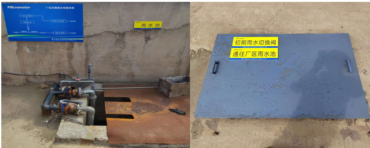
初期雨水池及转换阀门
