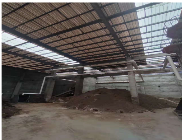
二期陈化库废气负压管道
