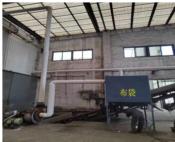
一期工程造粒废气负压收集系统
