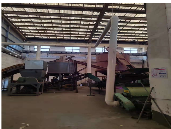
皮屑预处理车间破碎负压收集
