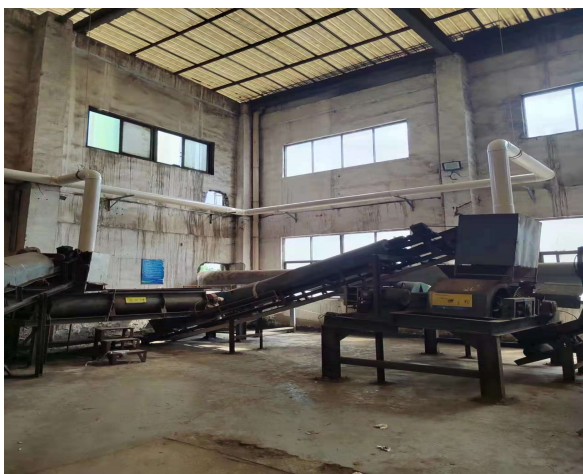
一期工程造粒废气负压收集系统
