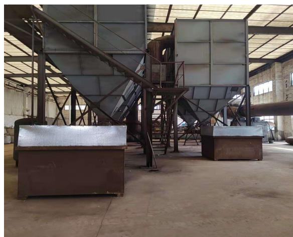
一期工程回转窑烟气处理布袋除尘器
