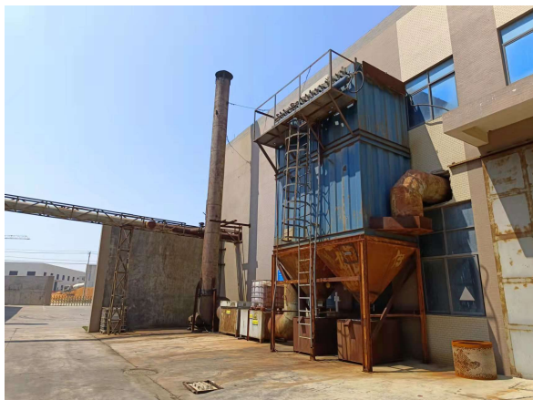
皮屑预处理车间烘干尾气布袋除尘器
