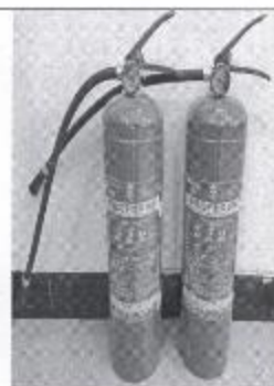
站房消防设施
