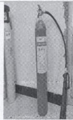
站房消防设施
