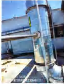
DA001 排气筒进口 Q01
