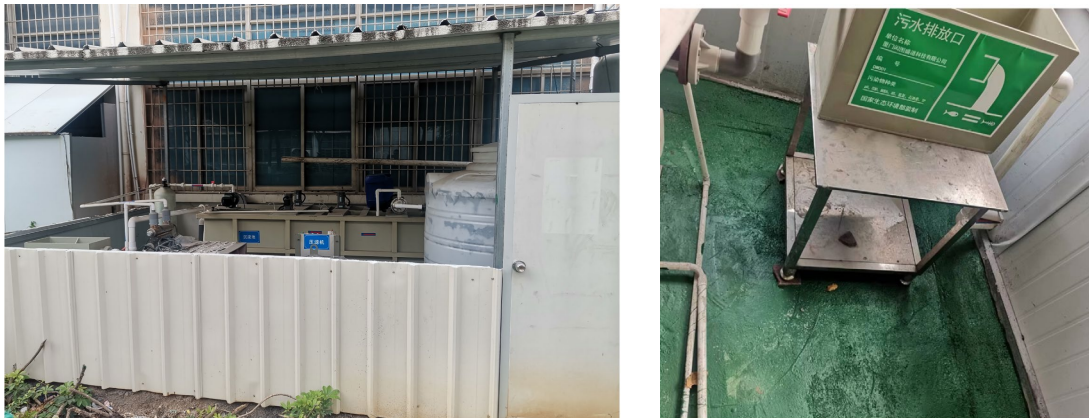
图 3-1 厂区污水处理站现场照片
