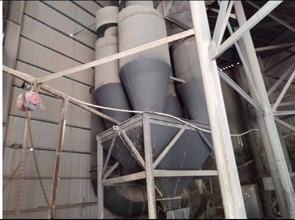
本项目现状-干燥废气旋风除尘装置
