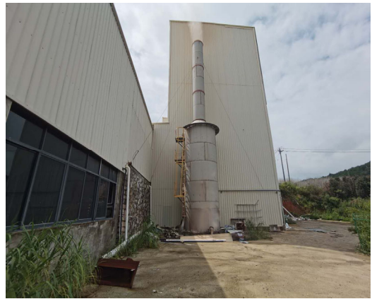
本项目现状-干燥废气喷淋装置及排气筒
