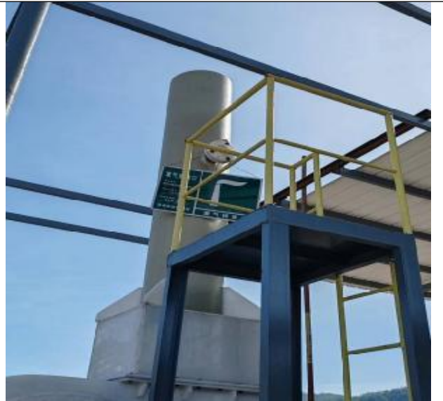
石膏渣库放渣时渣气（3#产线）排气筒采样平台
