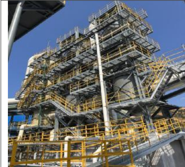
工艺废气和石膏渣库库顶渣气综合治理设施 二级气动乳化塔+碱洗塔
