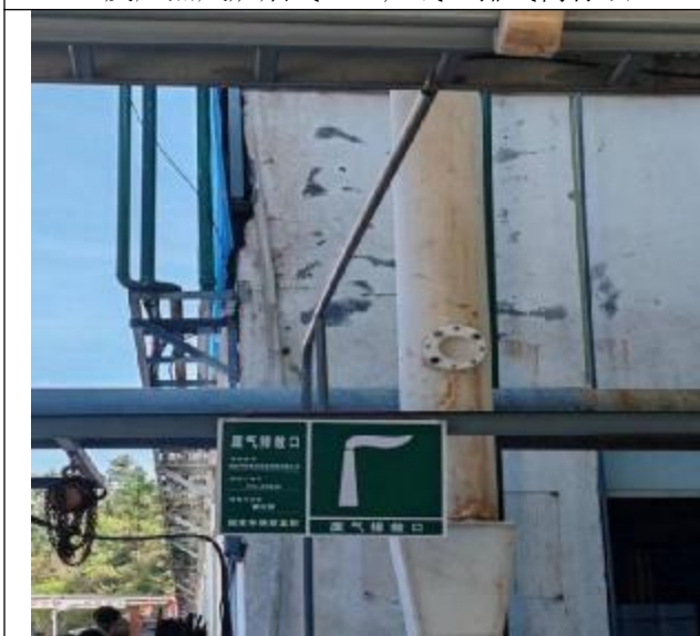
AHF、BHF 罐区呼吸废气排气筒标识
