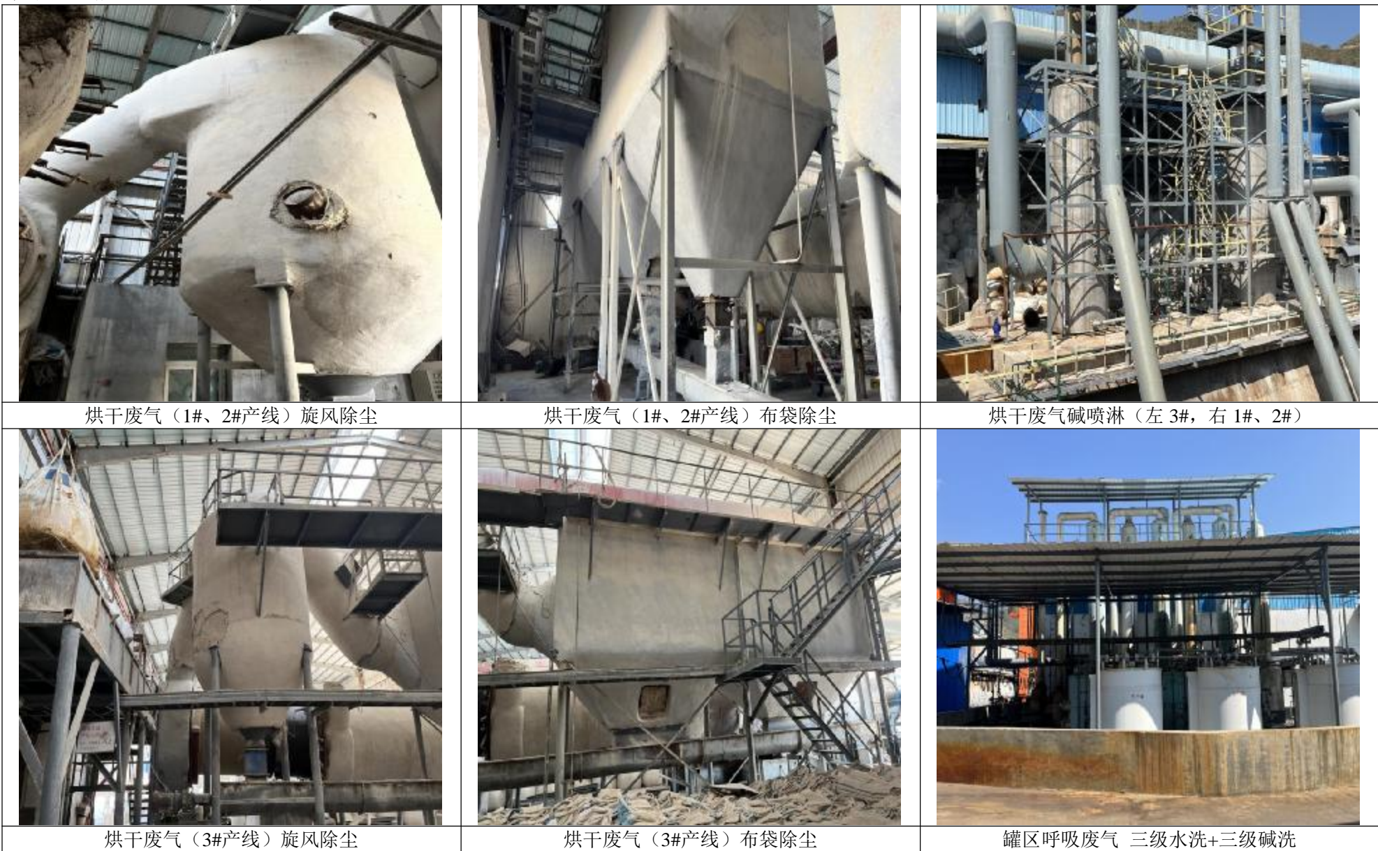
附图 5：废气治理设施现状
