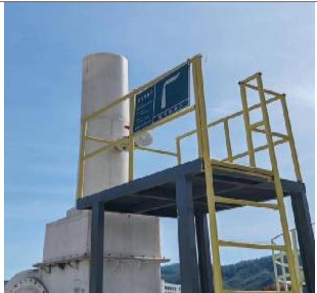
石膏渣库放渣时渣气（1#产线）排气筒采样平台
