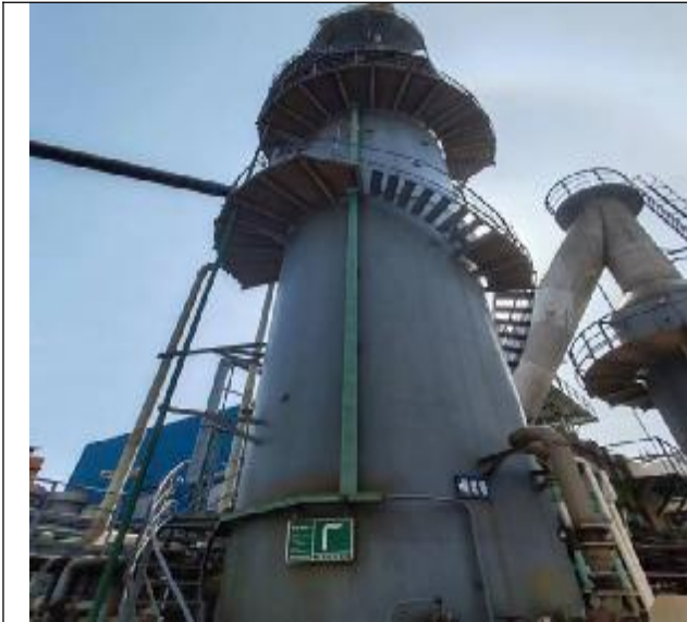
工艺废气与石膏渣库顶渣气排气筒标识
