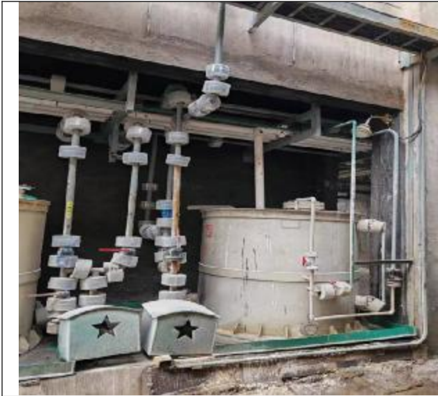
石膏渣库放渣渣气（1#产线）一级碱洗
