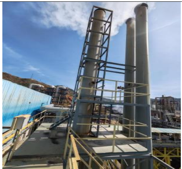
反应热风炉烟气（2#产线）排气筒采样平台
