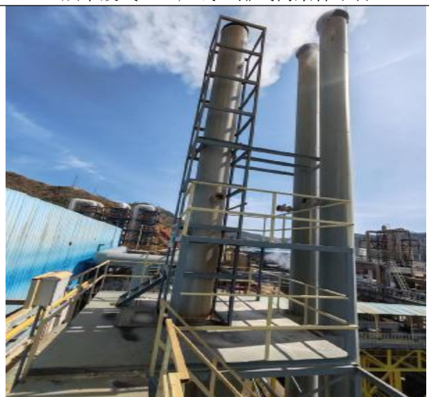
反应热风炉烟气（1#产线）排气筒采样平台
