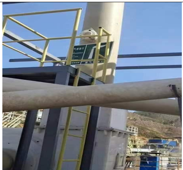
石膏渣库放渣时渣气（2#产线）排气筒采样平台
