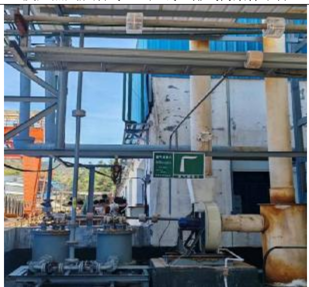
AHF、BHF 罐区呼吸废气排气筒采样平台
