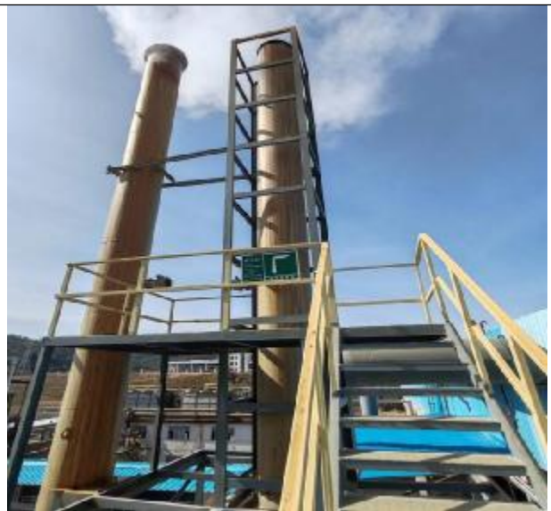
反应热风炉烟气（3#产线）排气筒采样平台
