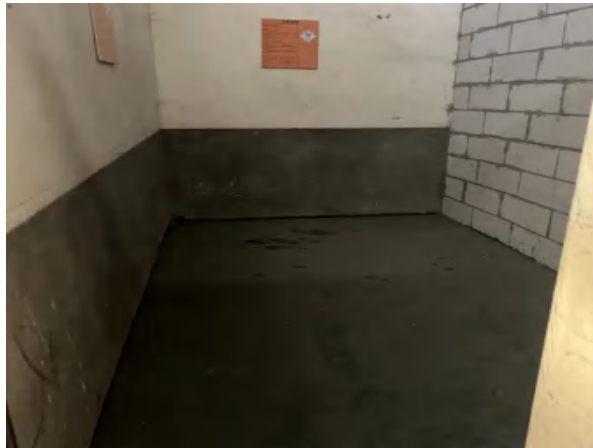
危险废物暂存间（内）
