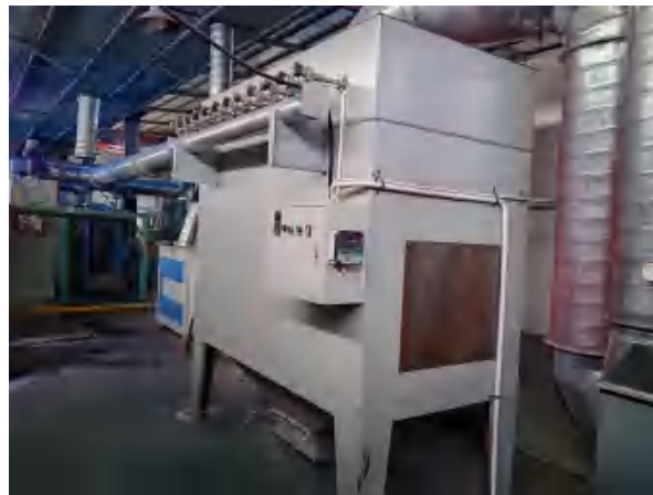
袋式除尘器（喷粉工序）
