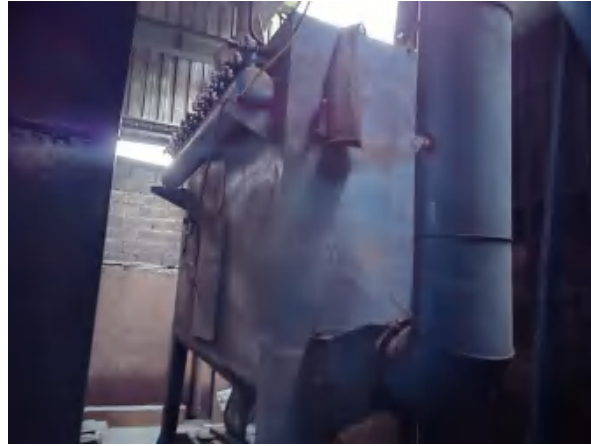
滤筒除尘器（抛丸工序）
