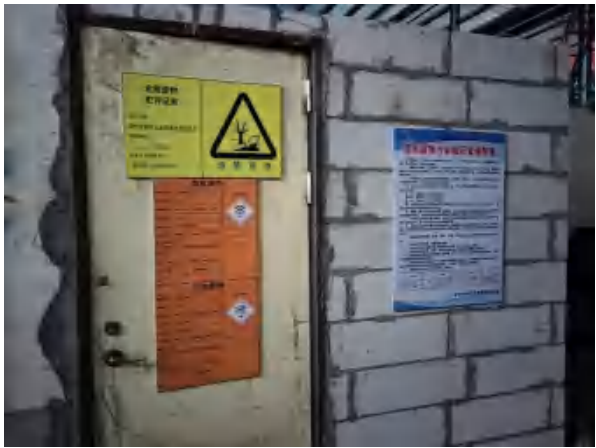
危险废物暂存间（外）
