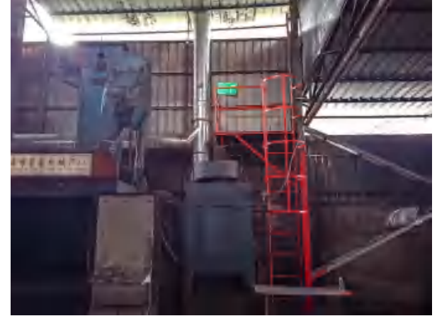
15m 排气筒+采样平台（抛丸工序）
