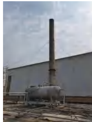
锅炉废气排气筒（30m）
