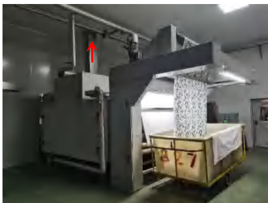
数码印花工序废气收集管道
