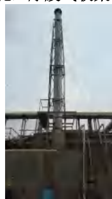
依托的排气筒平台 (DA018)
