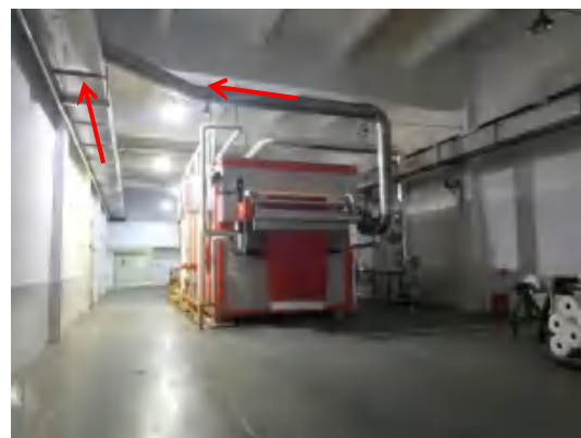
蒸化工序废气收集管道
