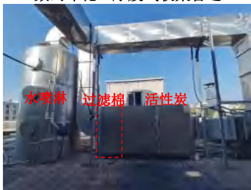
废气治理设施
