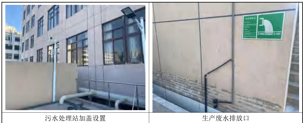
图 4.1.2 废水治理设施图片
