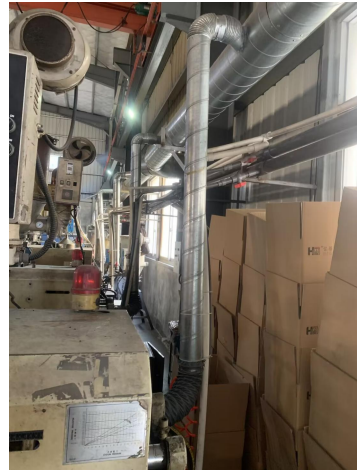
生产车间废气管道
