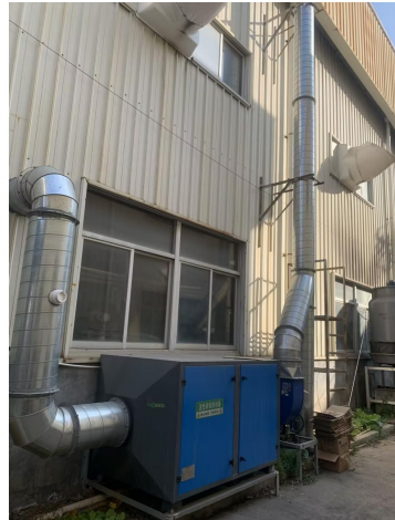
废气处理设施
