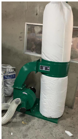
破碎车间布袋除尘器
