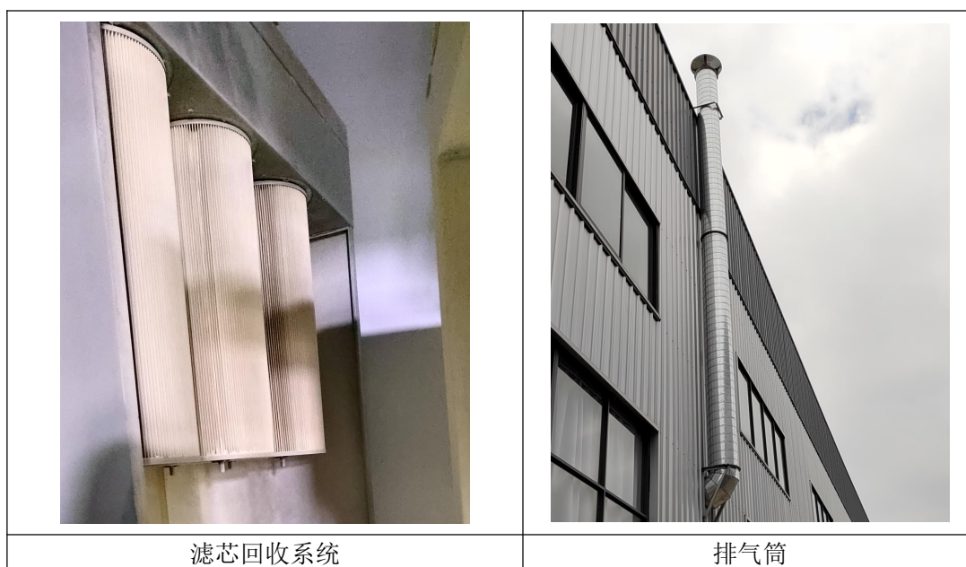
图 4-12 滤芯回收系统及排气筒
