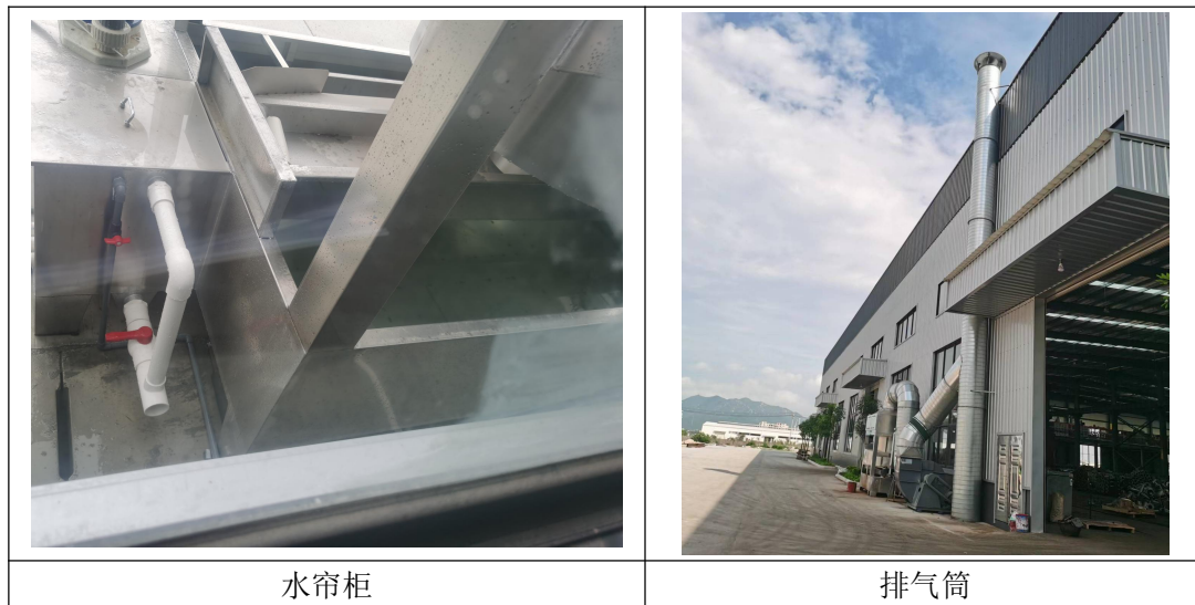
图 4-8 水淋柜及排气筒
