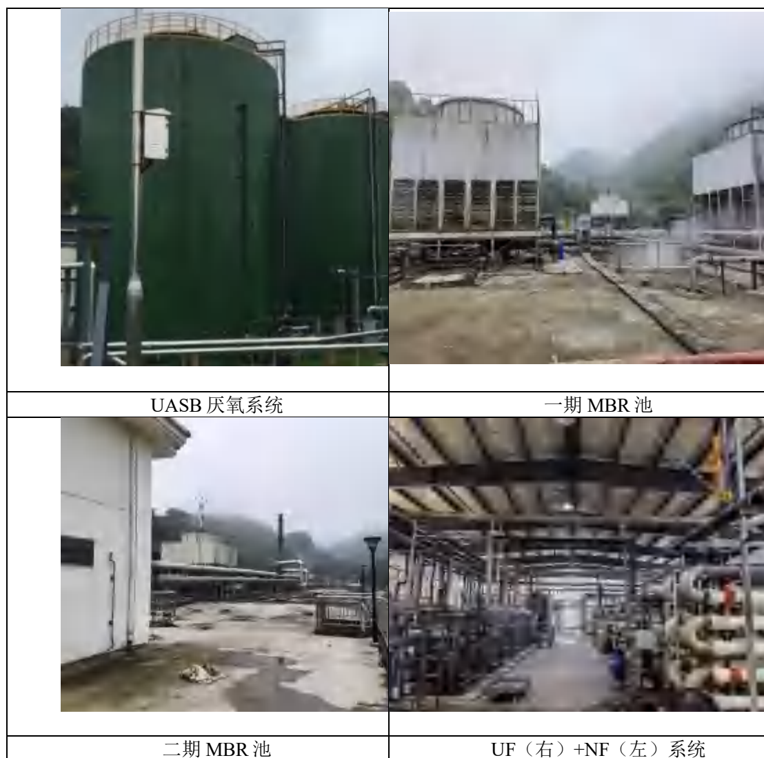
图 3.1-8 废水处理设施
