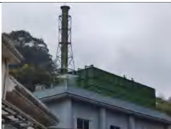
污泥脱水车间排气筒
