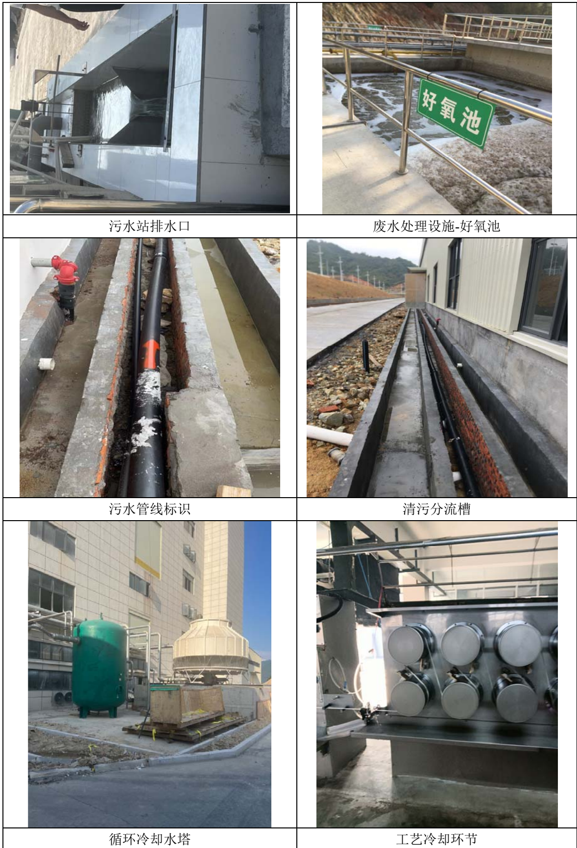
图 4.1-2 项目废水治理设施图
