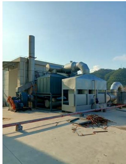
水喷淋+除雾+二级活性炭吸附 (DA002)
