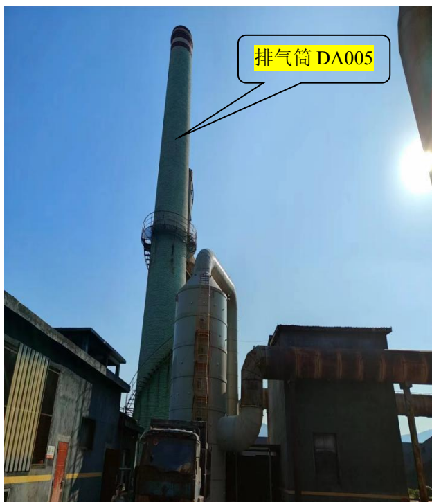
矿热炉脱硫塔
