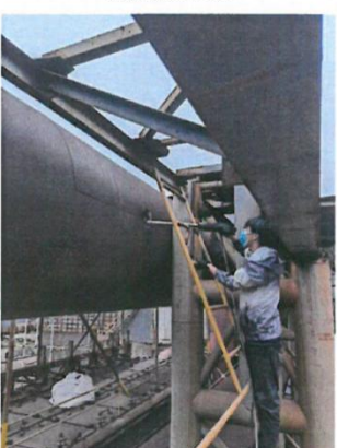
矿热炉废气处理设施进口 G10
