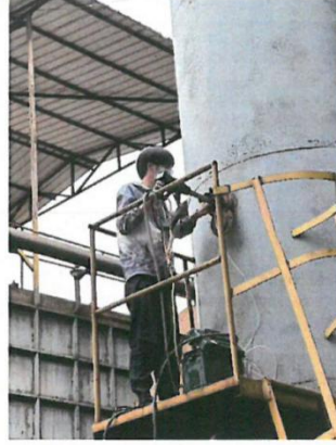
焙烧炉合格料卸料口废气排放口 (DA003) G7
