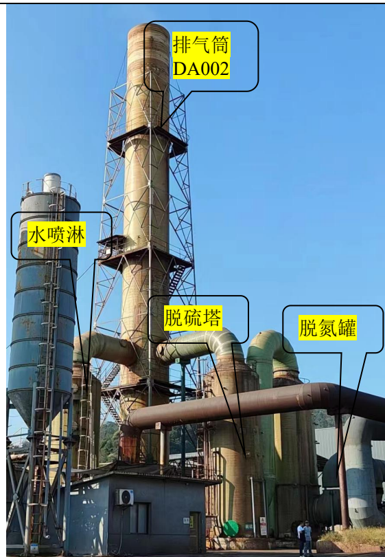
脱氮罐、水喷淋、脱硫塔
