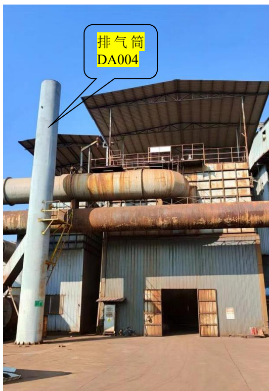
卸料粉尘布袋除尘器
