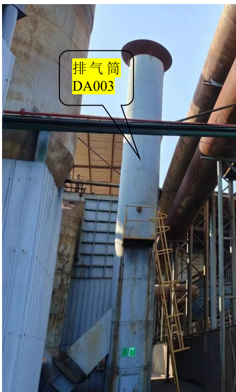
卸料粉尘布袋除尘器
