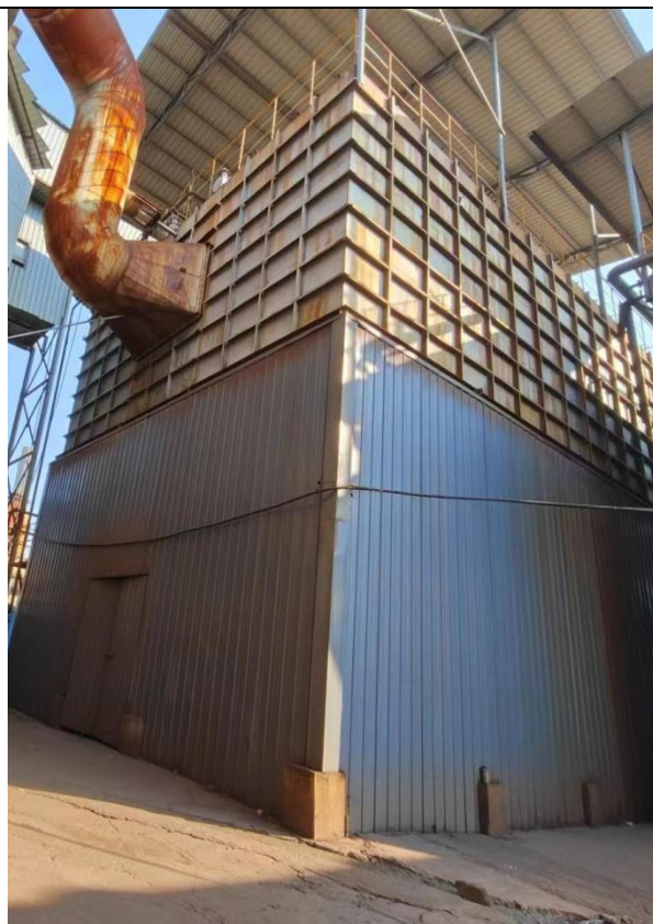
焙烧炉布袋除尘器
