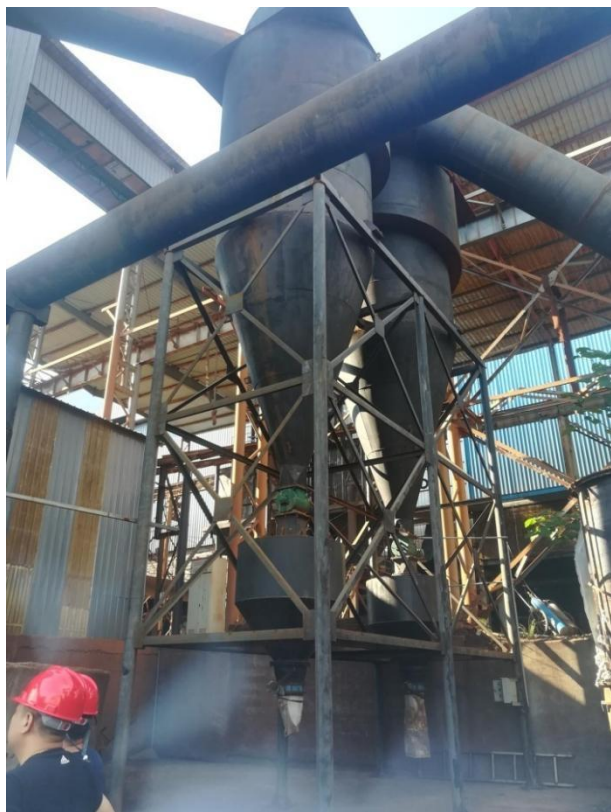
焙烧炉旋风除尘器
