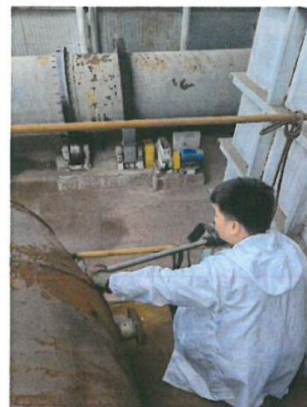
危废原料烘干窑废气处理设施 进口 G4
