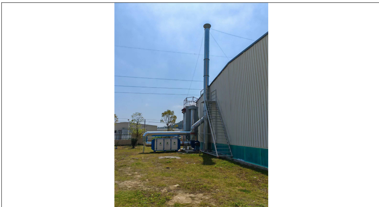
脉冲除尘器+活性炭吸附装置+15 米高排气筒 (DA001)
