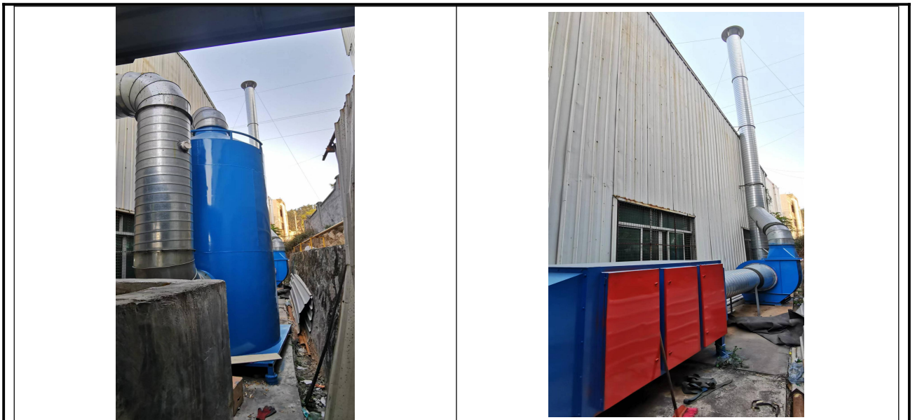
水喷淋+活性炭吸附装置+18米高排气筒（DA009）
