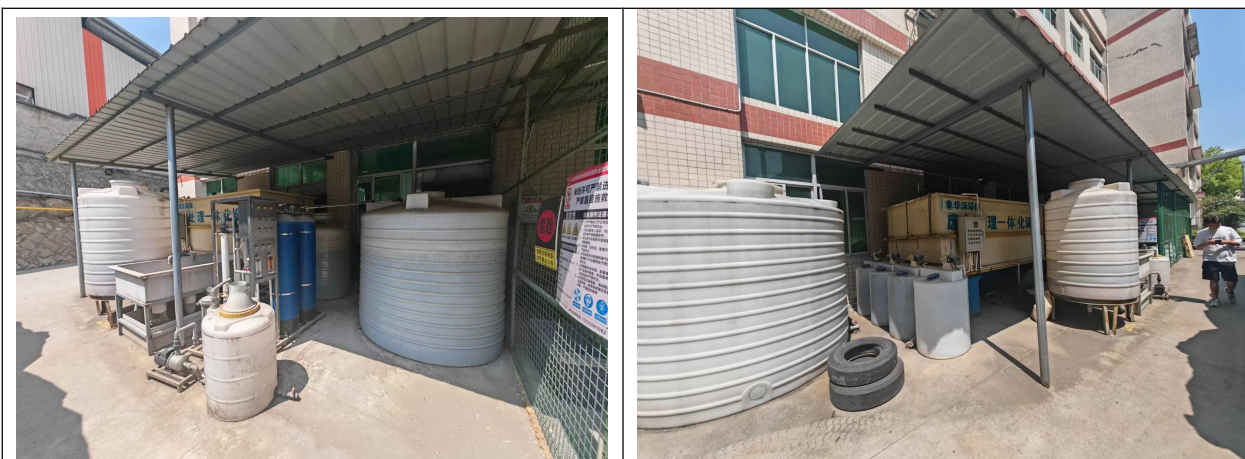
废水处理设施
