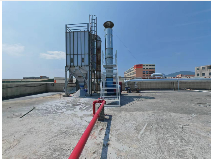
脉冲除尘器+20 米高排气筒 (DA004)
