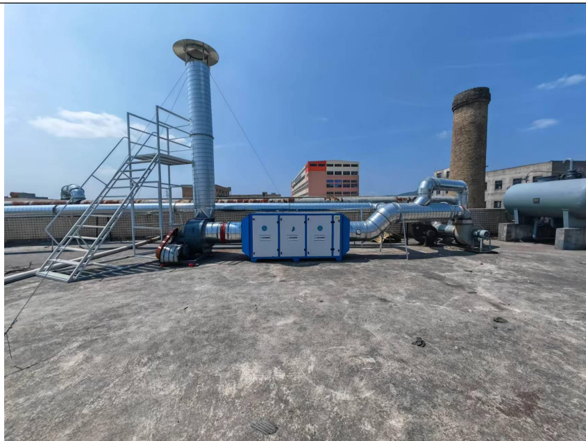
活性炭吸附装置+20 米高排气筒 (DA005)
