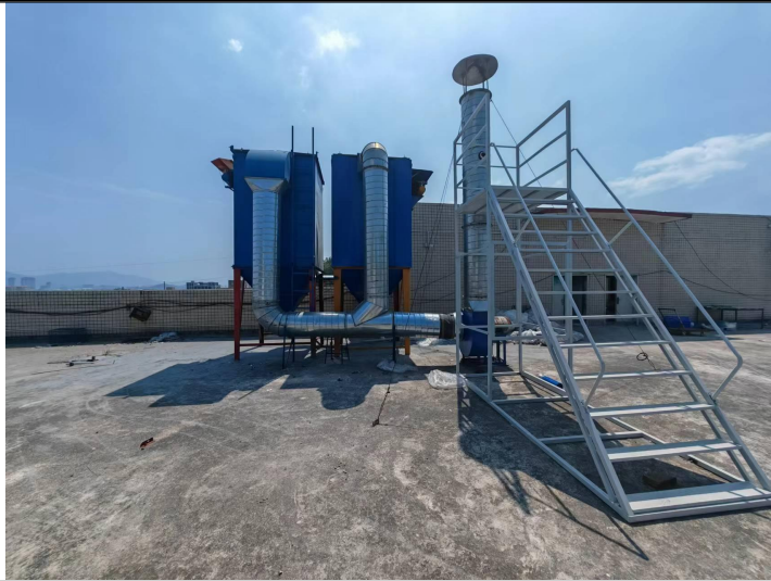
脉冲除尘器+20 米高排气筒 (DA003)
