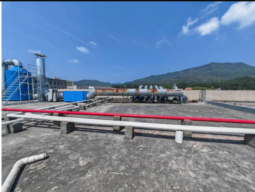
活性炭吸附装置+20 米高排气筒 (DA006)
