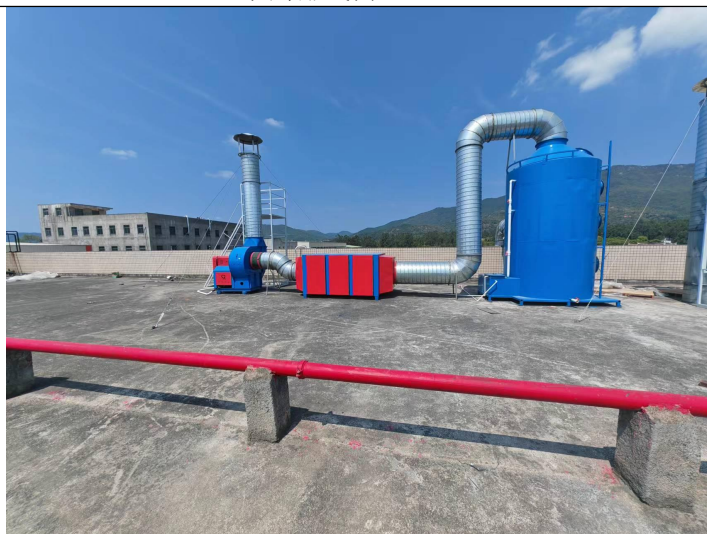
水喷淋+活性炭吸附装置+20 米高排气筒 (DA008)
