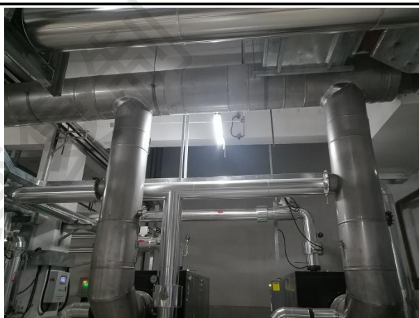
废气收集管道
