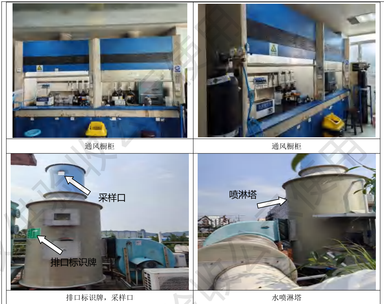
图 3.1-4 项目废气治理设施配置情况
