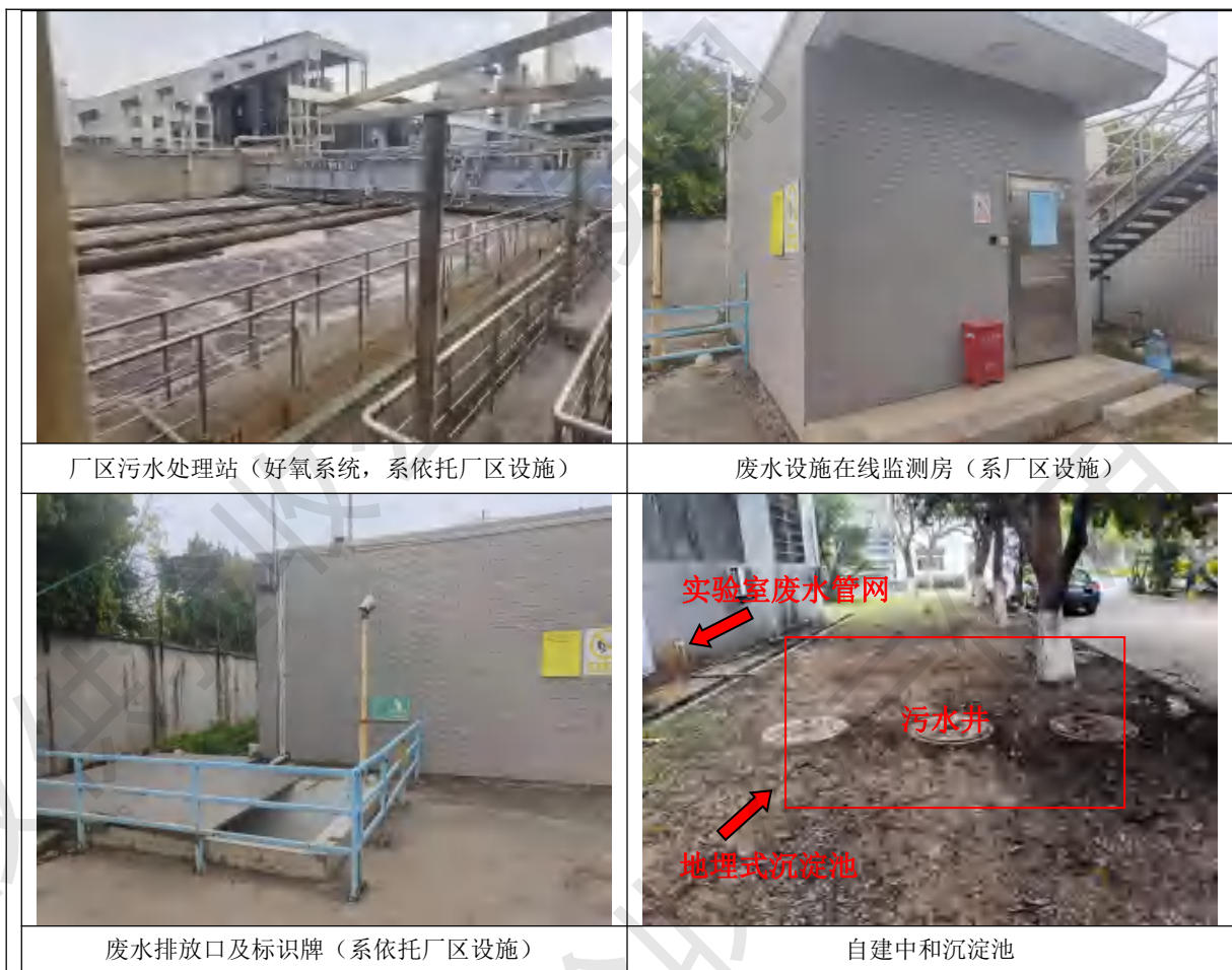
图 3.1-2 项目废水治理设施配置情况
