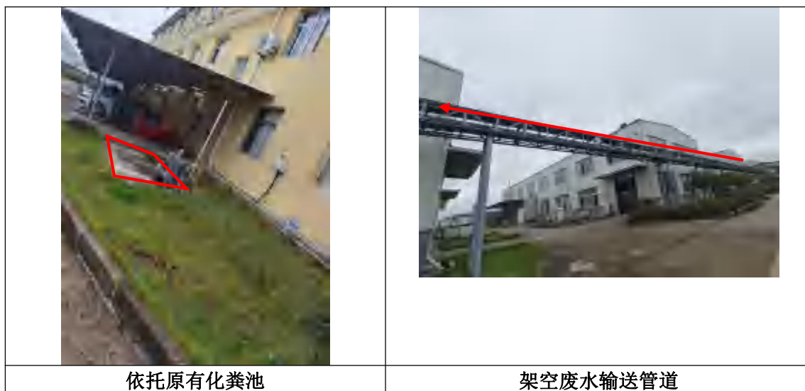
图 4.1-3 废水处理设施现状图
