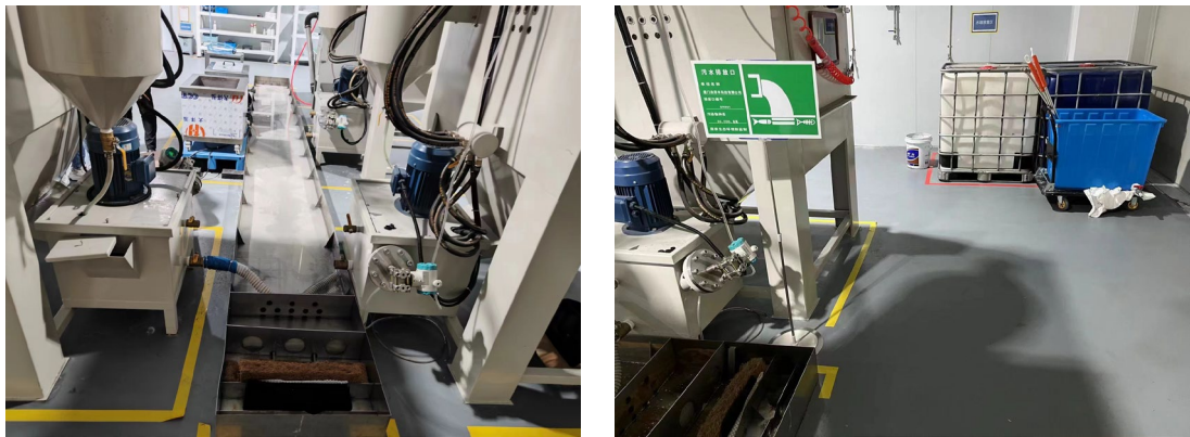
图 3-1 厂区污水处理设施现场照片
