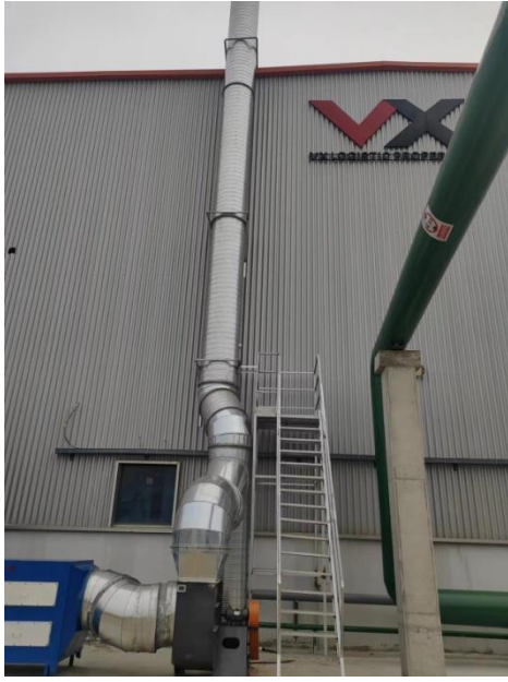
活性炭净化塔及其排气筒
