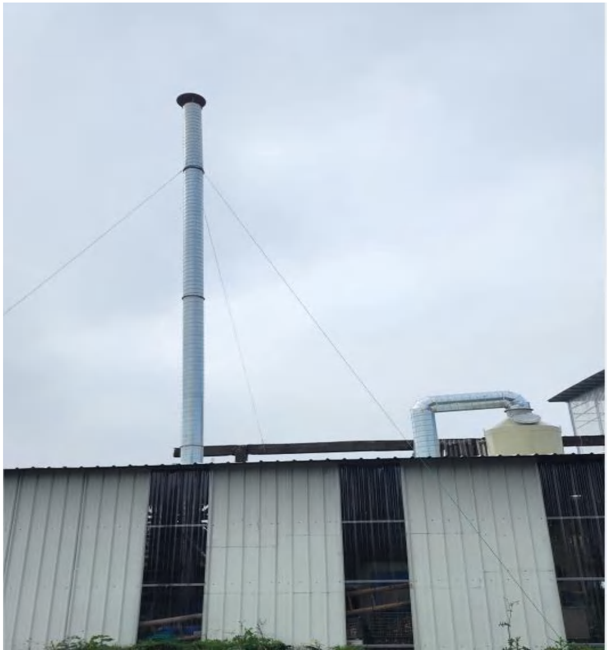
喷淋塔+生物除臭装置+18m 排气筒 (DA001) 排放
