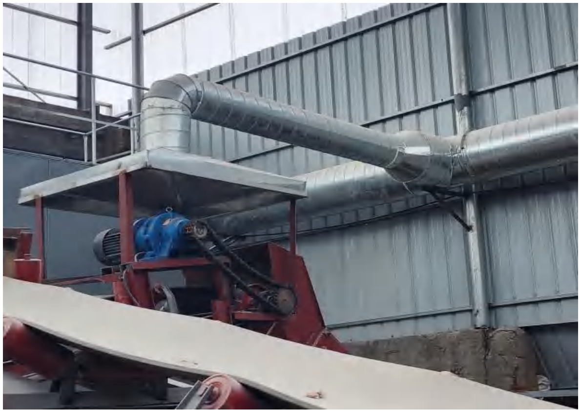
破碎工序集气罩及收尘管道
