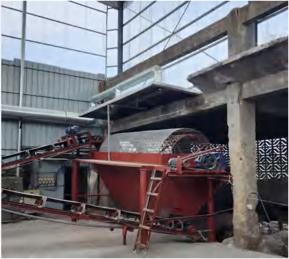
筛分工序集气罩+收尘管道
