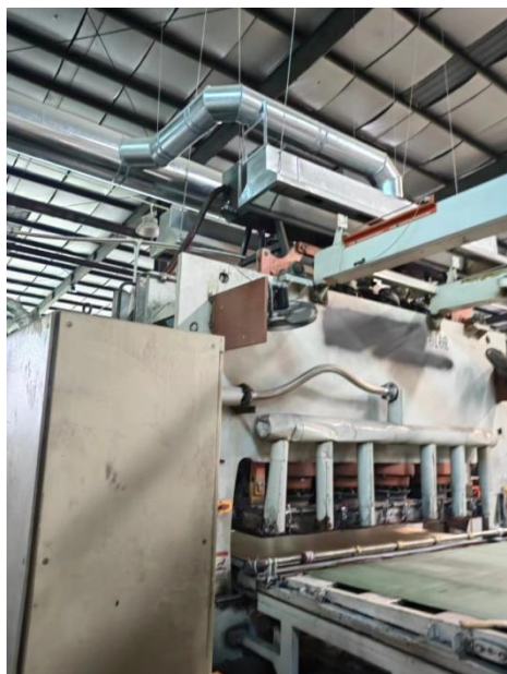
热压工序废气收集
