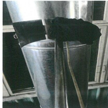
DA001 热压废气出口
