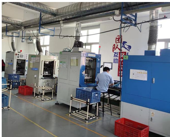
废气集气设施
