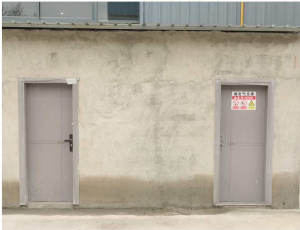
图片 2 液化气单独储存间
