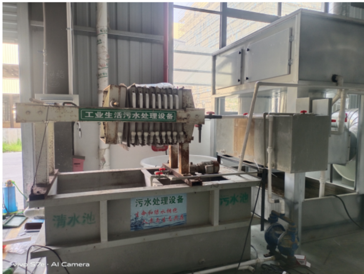
图 4-3 气旋塔废水处理设施图
