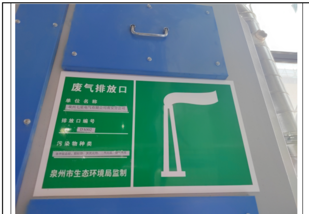
图片 4 喷粉后固化及燃料废气排放口标识牌
