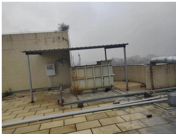
2.0t/d 混凝反应+沉淀+过滤”工艺污水设施
