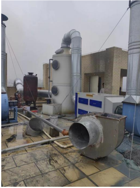
喷淋洗涤+活性炭吸附设施 (Q2 排气筒)
