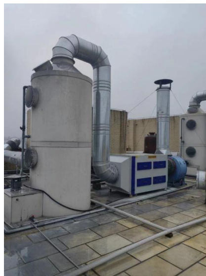
喷淋洗涤+活性炭吸附设施 (Q1 排气筒)
