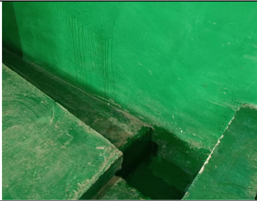
危废间围堰内收集槽
