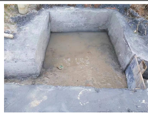
低洼处应急收集池
