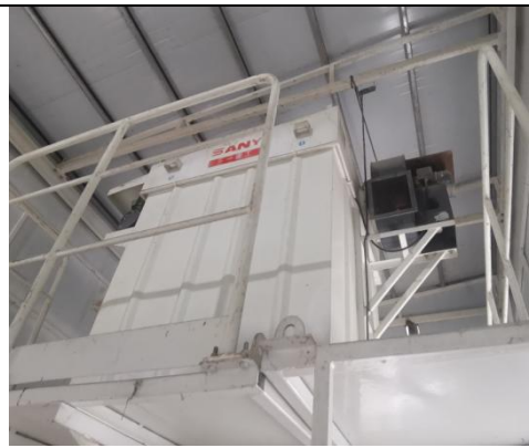
搅拌工序脉冲布袋除尘器
