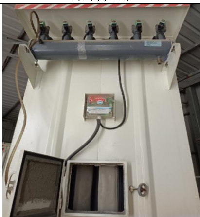
筒仓顶部脉冲布袋除尘器
