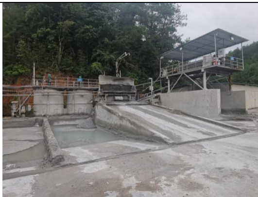
三级沉淀池、清水池及板框压滤机（斜坡为洗车区，右侧顶棚区域为板框压滤机，清水池位于板框压滤机后侧）
