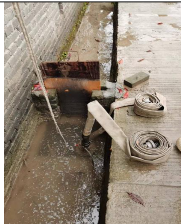
雨水沟应急水泵
