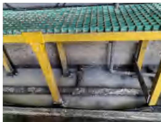
前处理槽溢流托盘
