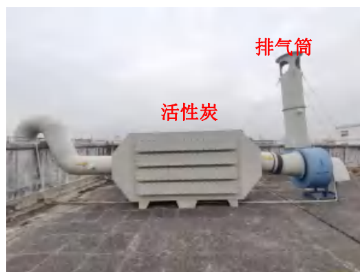
废气处理设施（活性炭吸附）
