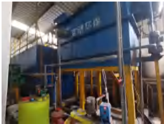
废水处理设施
