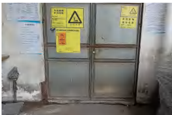
危废暂存间标识
