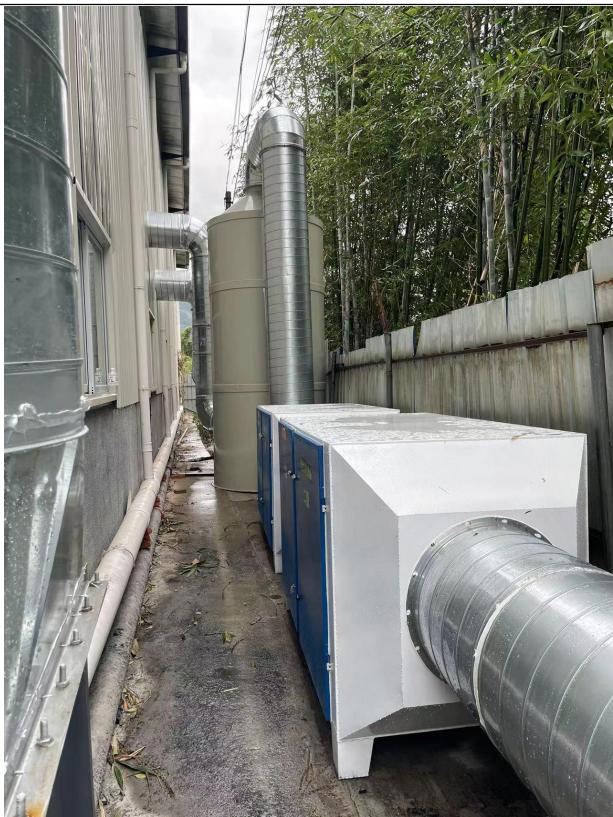
有机废气处理设施
