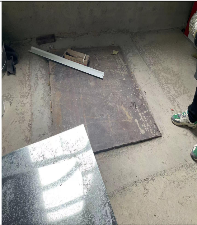
车间内收集池
