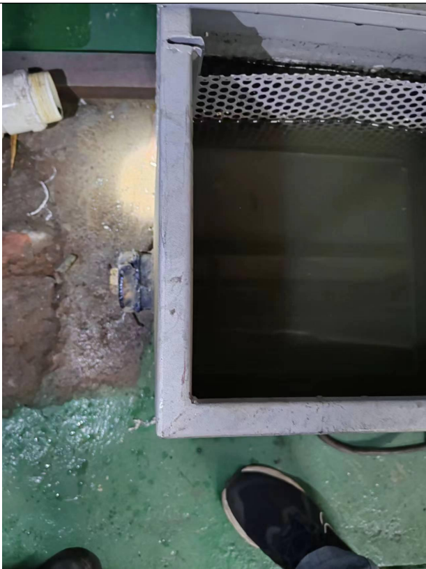
水帘柜循环水池
