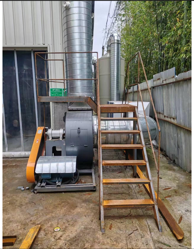
废气排气筒 (DA008)
