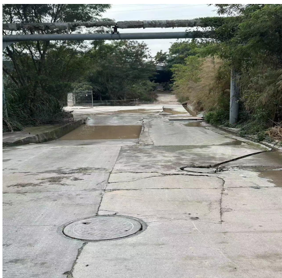
洗车台及沉淀池
