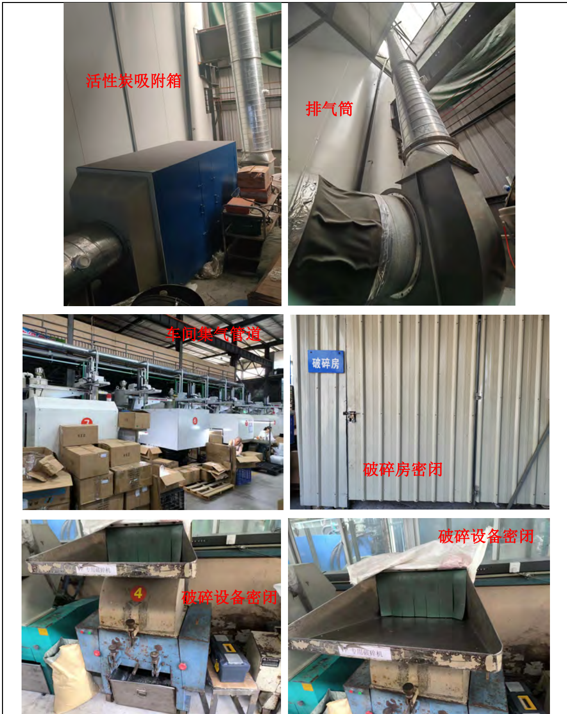
图 3-1 废气污染防治措施照片
