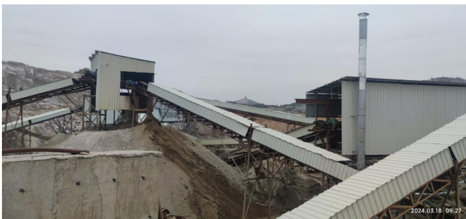
制砂粉尘收集排气筒
