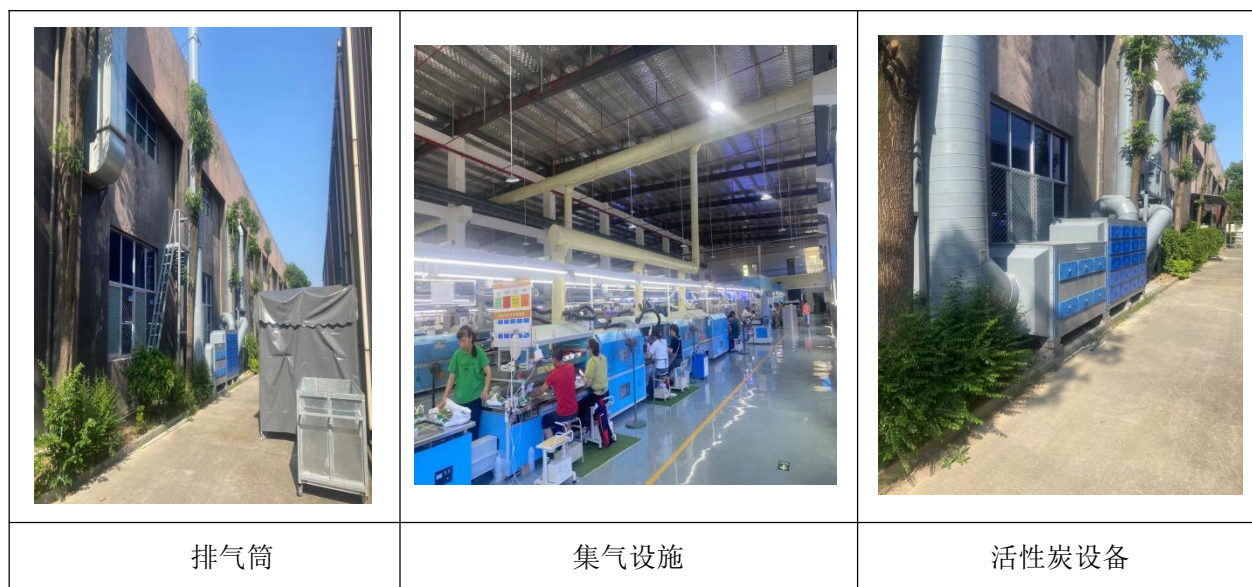
图 5.2-2 废气处理设施照片
