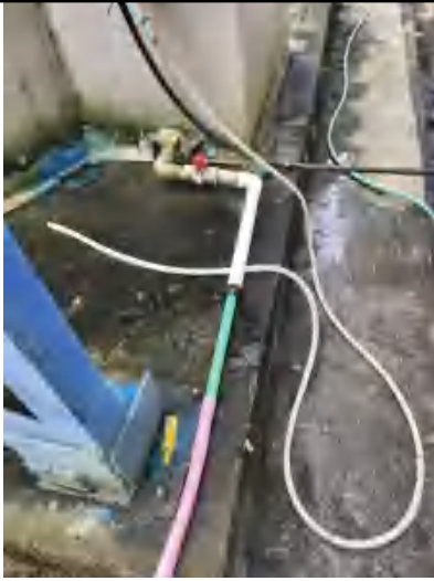
喷淋废水收集管道
