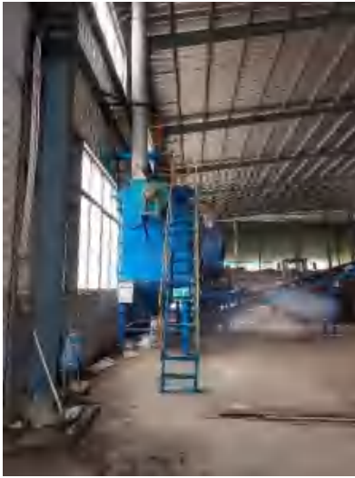
粉尘废气排放口+袋式除尘器
