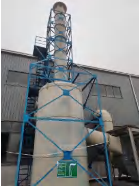
发酵废气排放口+喷淋除臭设施
