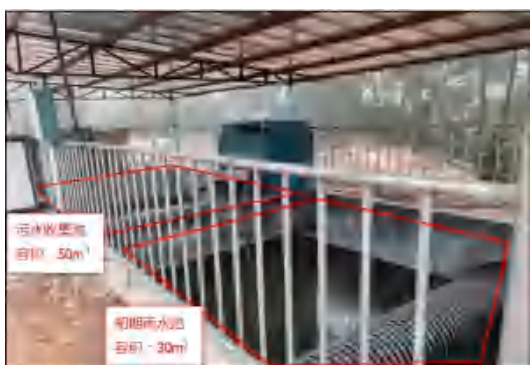
污水收集池及初期雨水池
