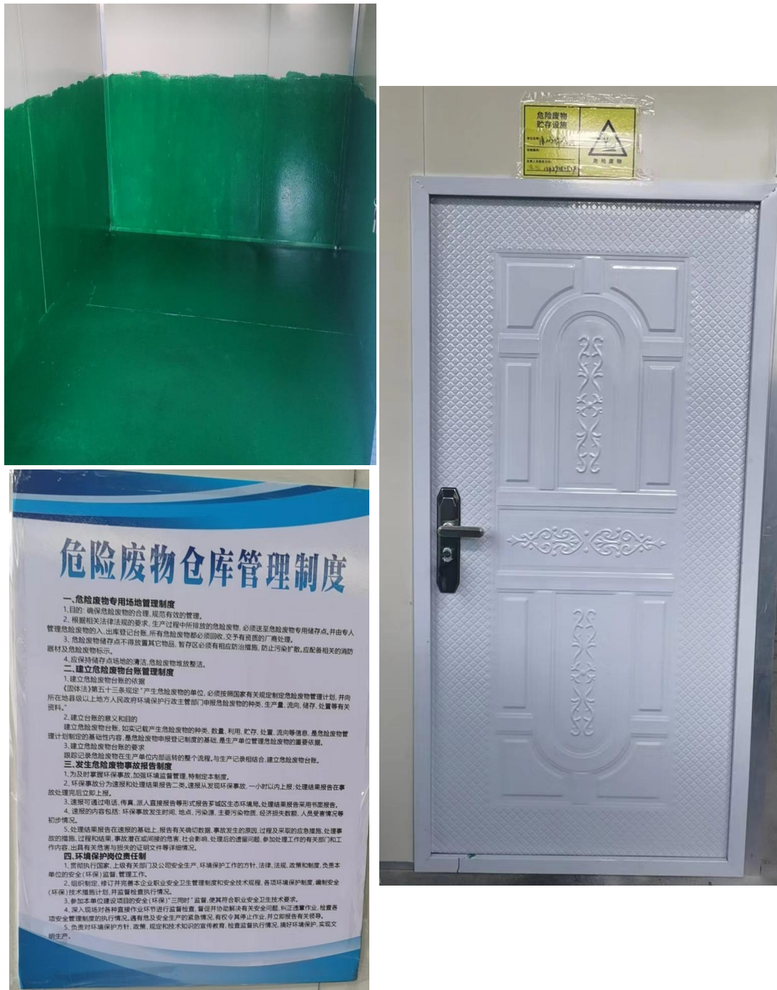
图 4-3 项目危废暂存间
