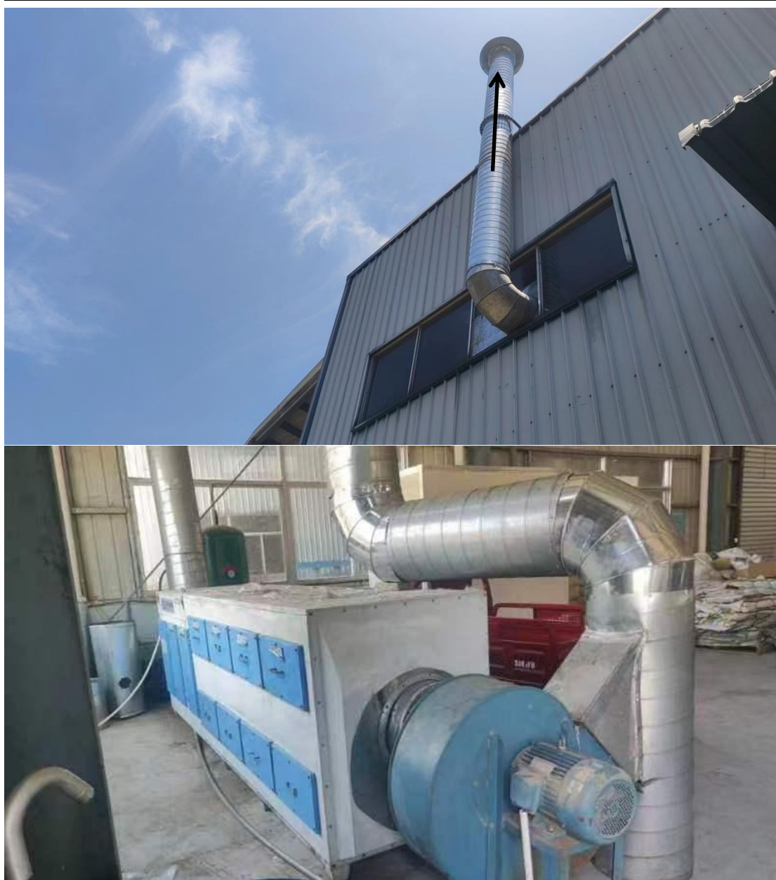
图 4-2 项目有机废气处理设施及排气筒
