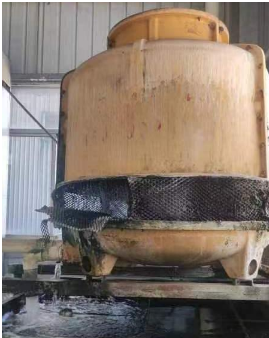
图 4-1 项目注塑冷却水循环水池
