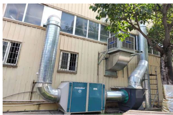
1#厂房：活性炭吸附装置+排气筒 (DA001)
