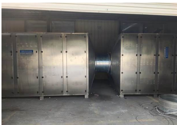
2#厂房：干式过滤器+活性炭吸附装置
