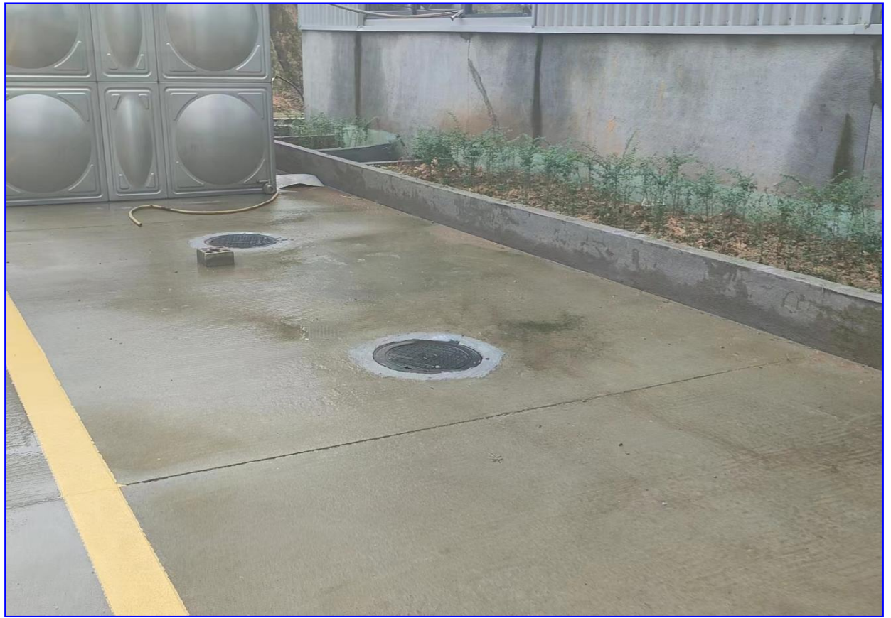
废水处理处理设施
