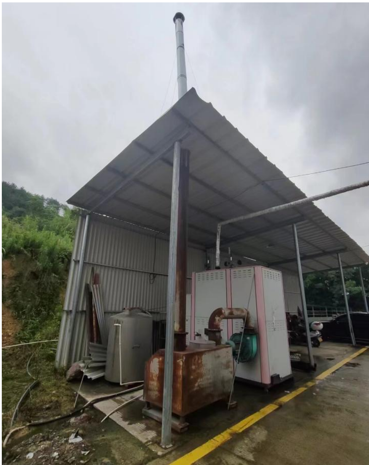
蒸汽发生器烟气经水膜除尘器+25m 高排气筒
