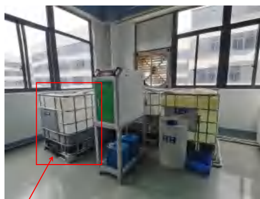
废水处理设施：油水分离器
