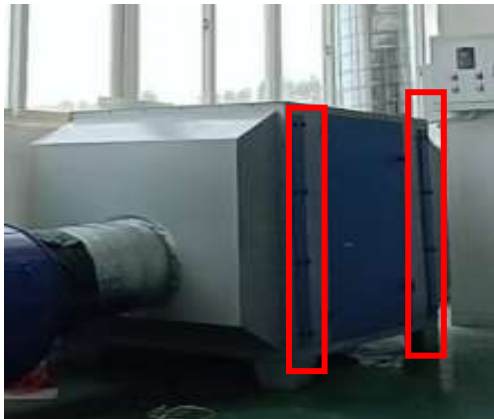
活性炭吸附装置现状
