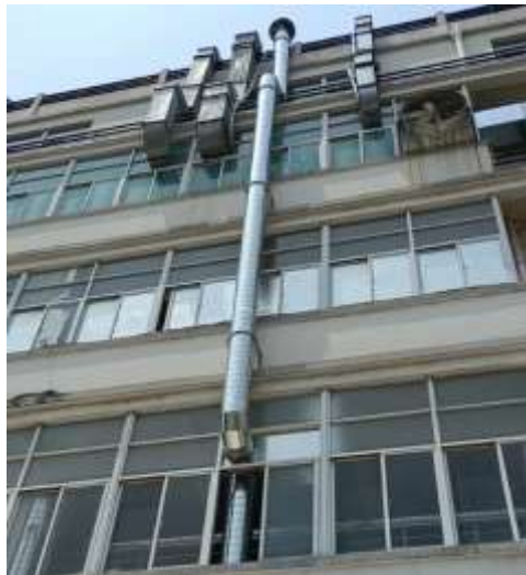
20m高排气筒
