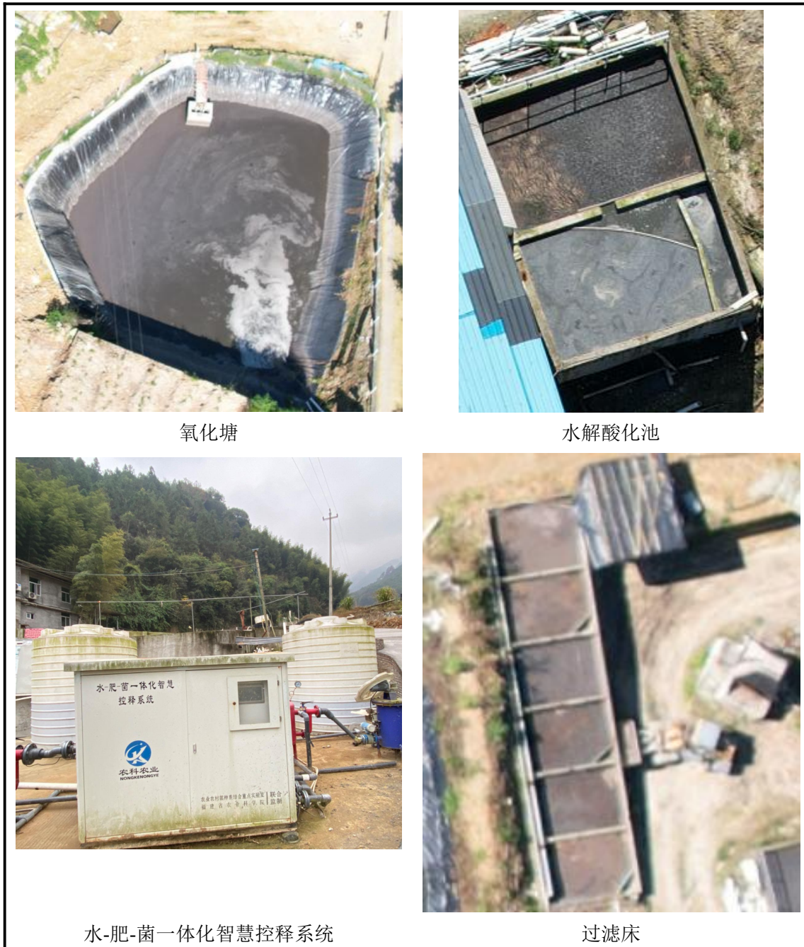
图 3.2-6 污水处理设施照片
