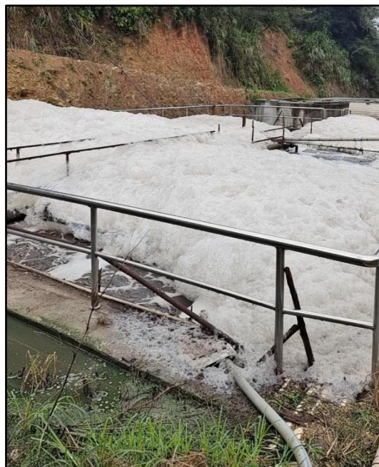
二段接触氧化池
