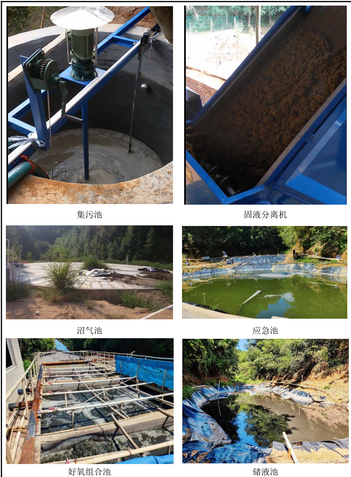
图 3.2-5 污水处理设施照片
